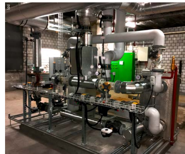
L'installation de chauffage à distance de SATOM.
