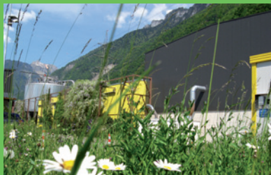
Installation de méthanisation et compostage, Villeneuve
