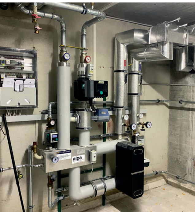
Échangeur thermique dans un bâtiment relié au thermorezo
